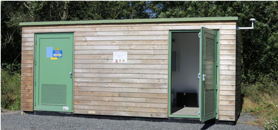
Figure 7 : Exemple d'un poste de livraison habillé d'un bardage en bois (source : AEPE Gingko, 2018)
